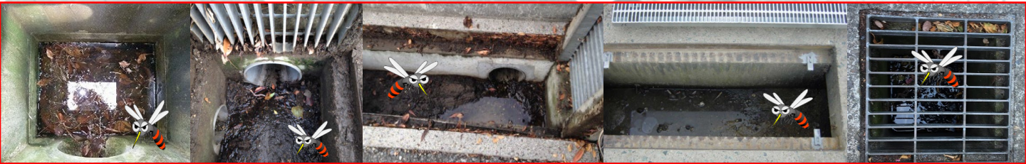
蚊の繁殖場所：公園、霊園の雨水枡、駐車場、歩道のU字溝や集水口
