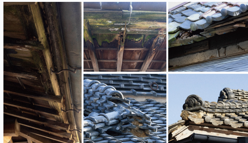
屋根瓦、縁側の屋根部分である庇（ひさし）の老朽化
